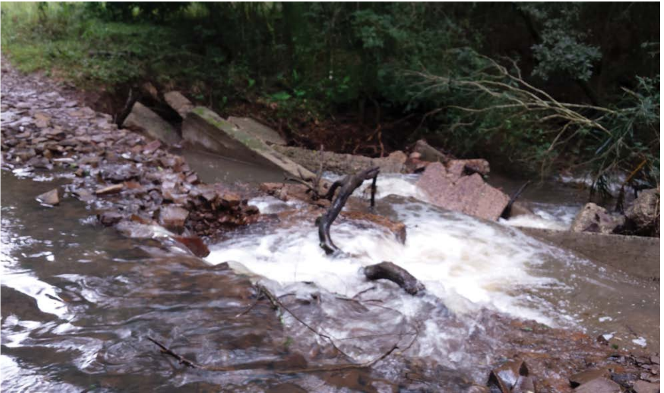
La fuerza del agua de las lluvias torrenciales se llevó consigo hasta tramos de 15 metros de caminería.
