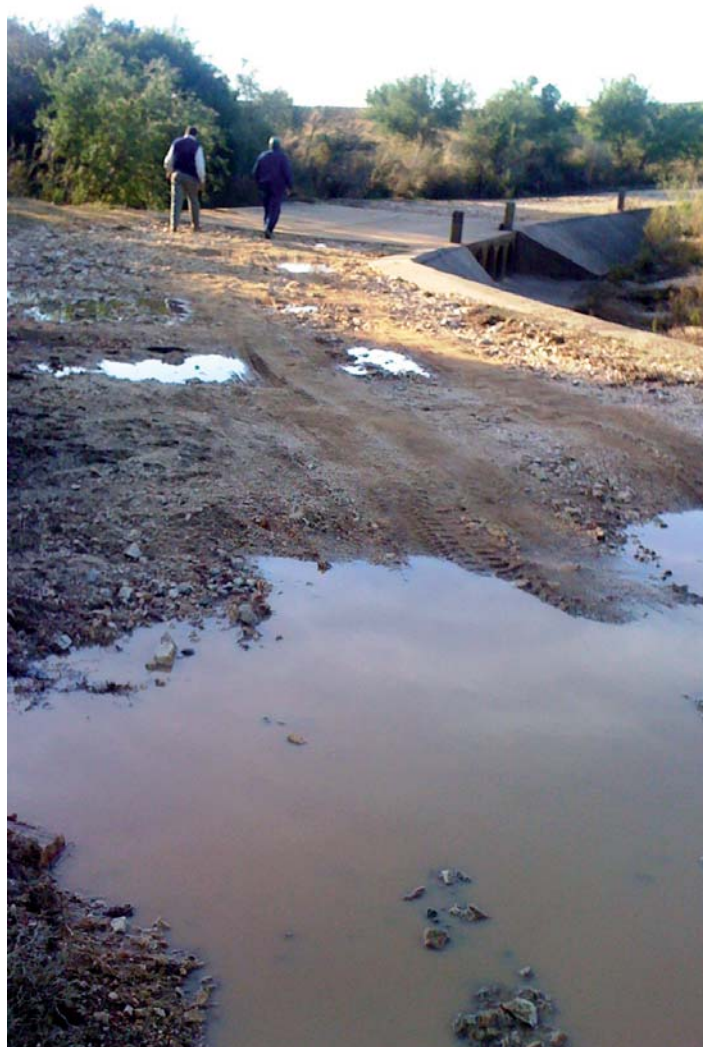
Roturas en ruta 19.
